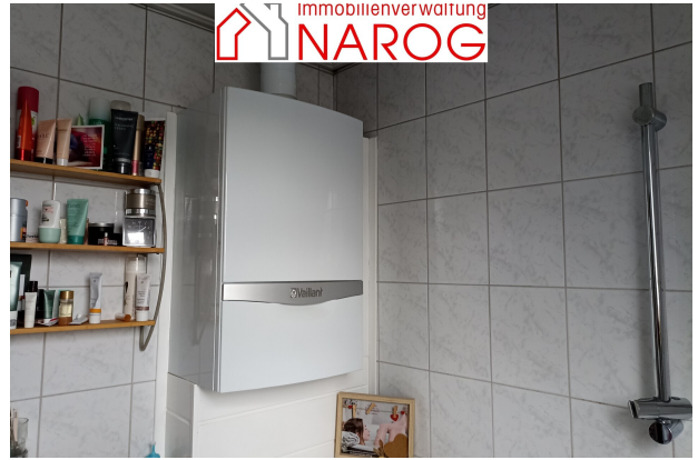
Heizungstherme im Bad
